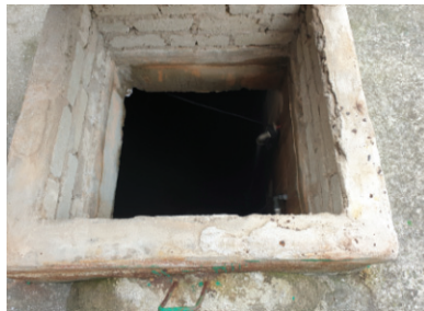
<지하저수조 위치 부적절> (b) 저수조
